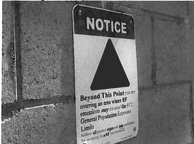
Notice sign at ATT BTS
